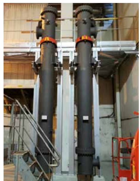
Chaleur Fatale Echangeurs d'eau surchauffée
